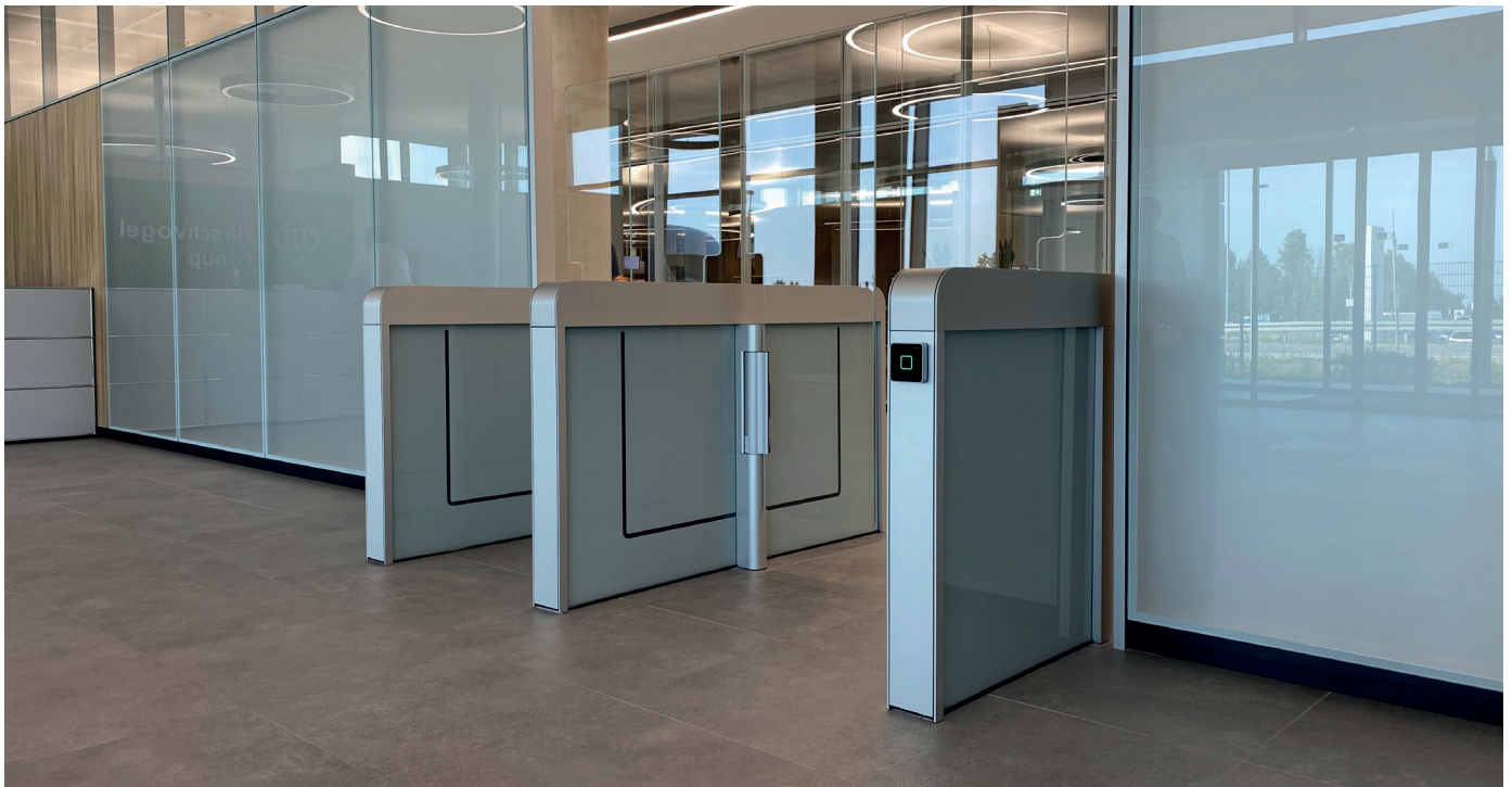
07 Vereinzelungsanlagen Argus im Innenbereich
